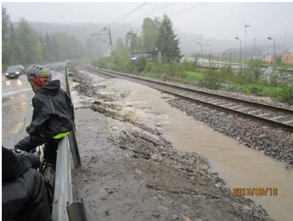
Figur 27: Översvämning av riksväg 90 och järnväg vid Väja den 19 september 2013. Foto: Kramfors kommun.
